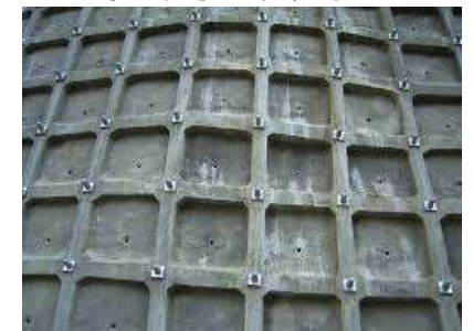
斜面の法面崩落防止用のアンカーボルト
