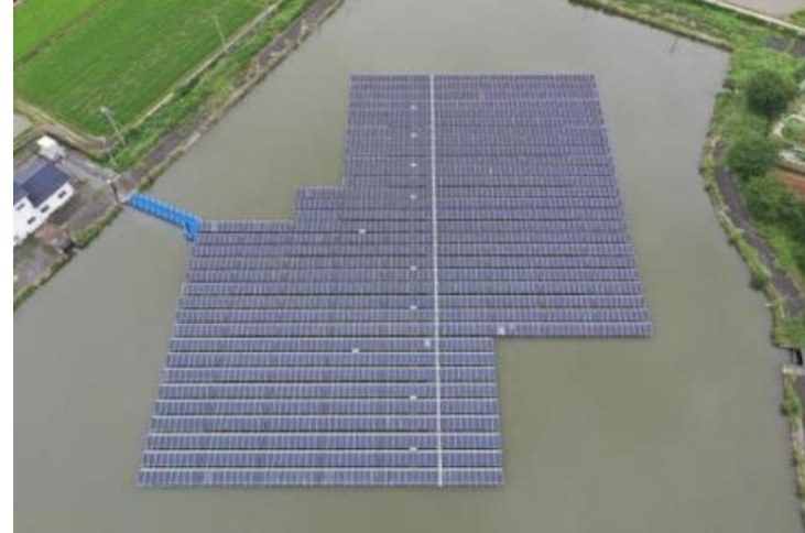
貯水池(パネル温度低下で性能向上)
